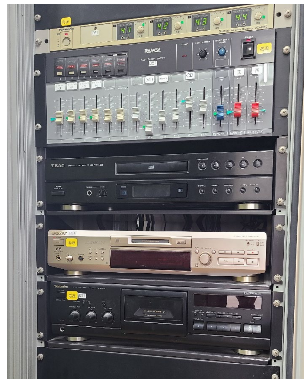
音響機器ラック
