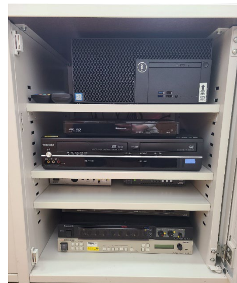
機器収納扉内
