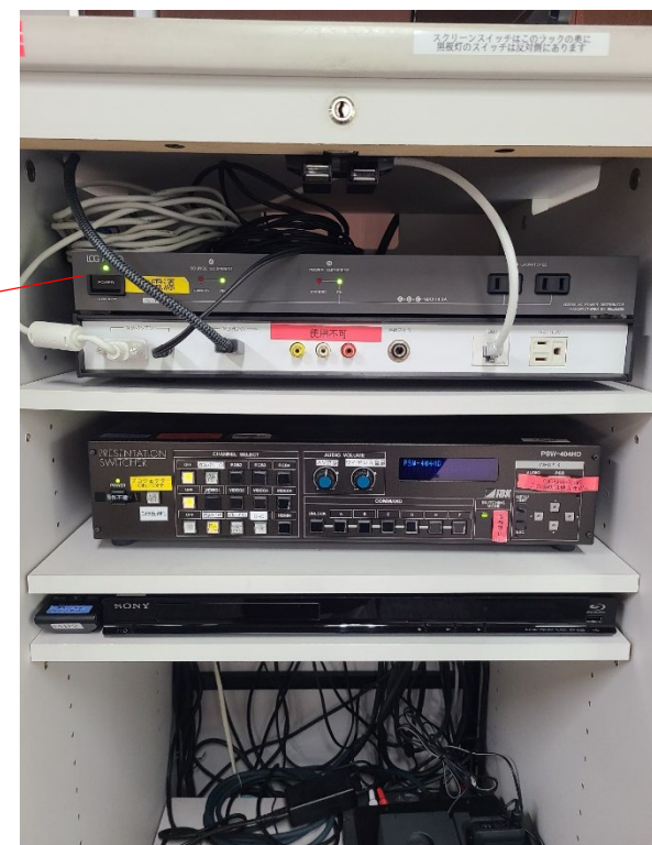
機器収納ラック
